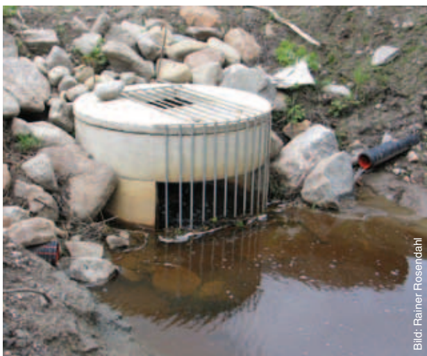
Bild 3. Kolla rissel och nackdikesbrunnar våår och höst.
