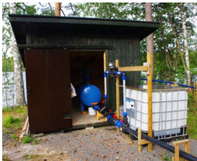
↑ Pumphuset skyddar elmotorn och sandfiltret samt dämpar pumpens ljud. I behållaren som är en kubikmeter stor görs stamlösningar för droppbevattningen.
