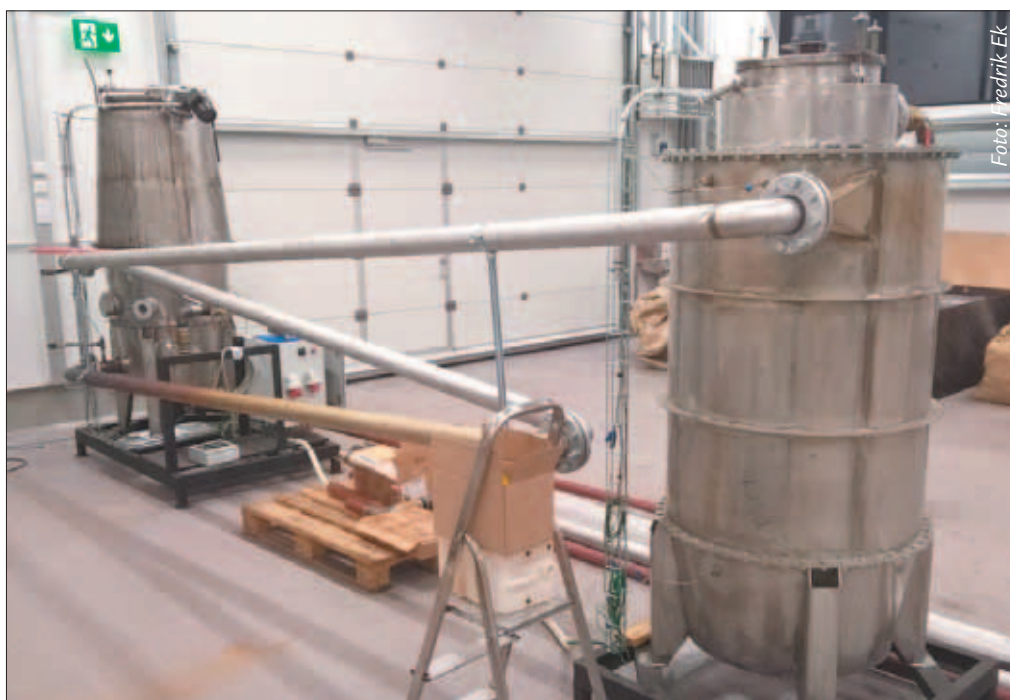
Förgasningsanläggning som omvandlar kolmonoxid, koldioxid och vätgas till metan.
